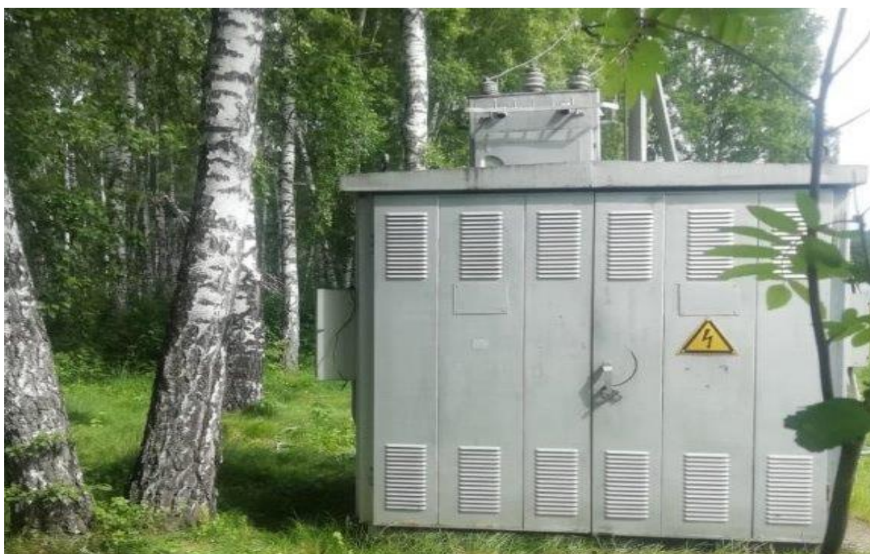
Фотография № 1. Трансформаторная подстанция № КЖ-7-13. Место несчастного случая.
