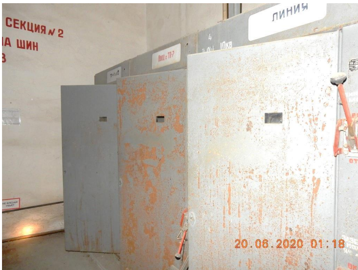
Фотография №3. Ячейки 2-й секции ТП-42. Двери ячеек открыты.
