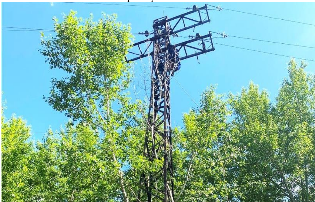
Фотография № 2. Опора №10 ВЛ 10 кВ №7 ПС Красноармейская.
