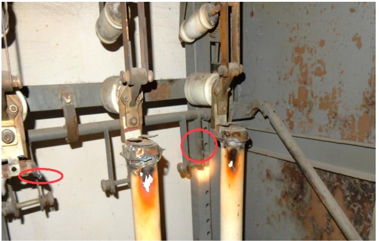
Фотография №4. Следы короткого замыкания в ячейке 10 кВ.
