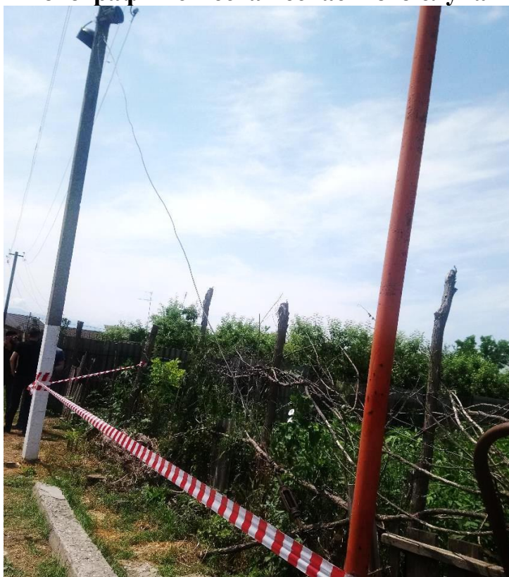
Фотография № 1. Место несчастного случая (общий вид на опору №5 отпайки №2 от опоры №11 ВЛ 0,4 кВ Ф-1 ТП-8-22)
